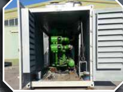
JENERATÖR KONTEYNER (GENERATOR CONTAINER)
