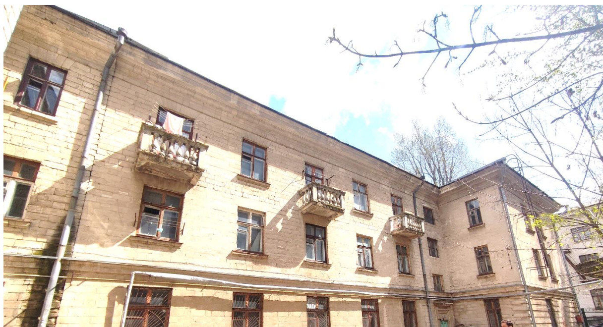
Fig. 6. Aspectul balcoanelor pe fațada din curte a clădirii căminului nr.4
