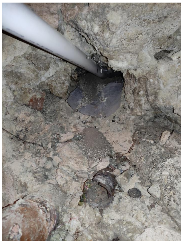
Fig. 9. Aspectul deteriorărilor pereților de soclu clădirii căminului nr.4 examinate
