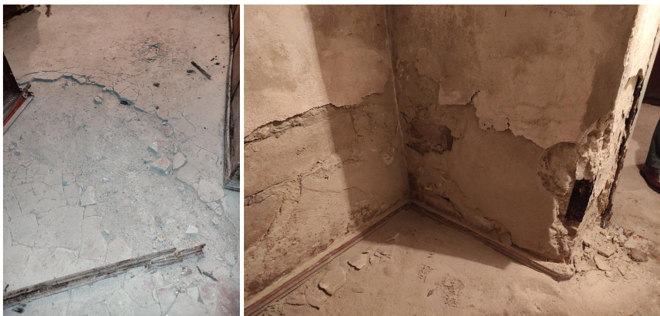
Fig. 10. Aspectul deteriorărilor elementelor la nivelul subsolului clădirii examinate
