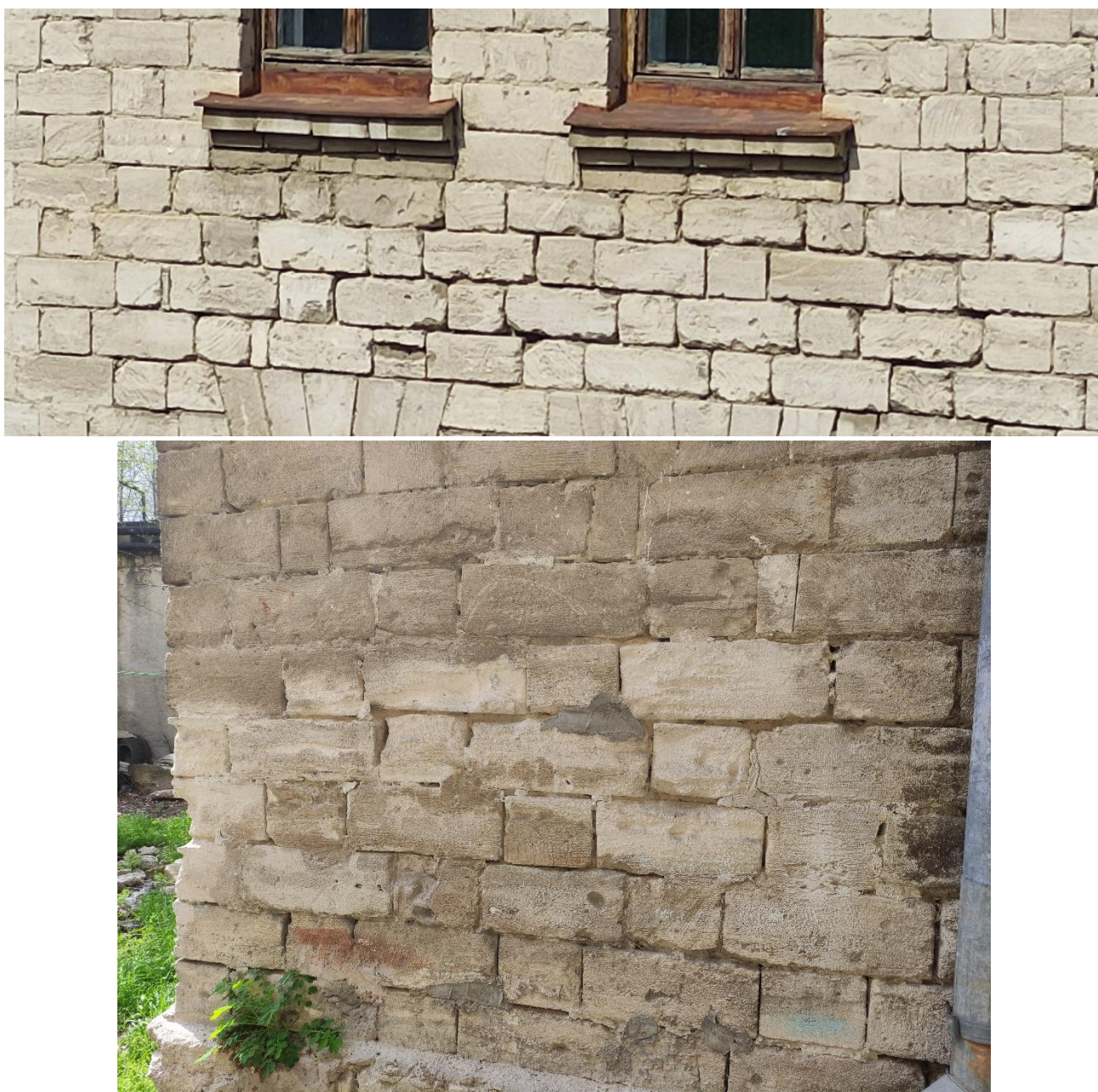
Fig. 15. Aspectul sectoarelor degradate a pereților exteriori clădirii examinate
