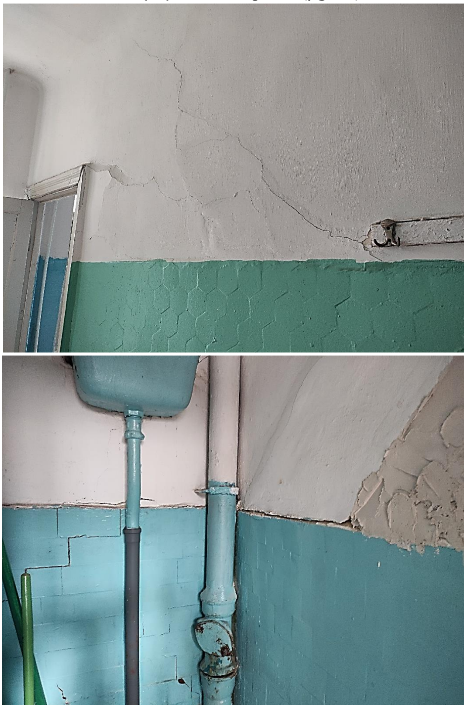
Fig. 13. Aspectul deformații și fisuri pereților grupurilor tehnico-sanitare și bucătărilor
