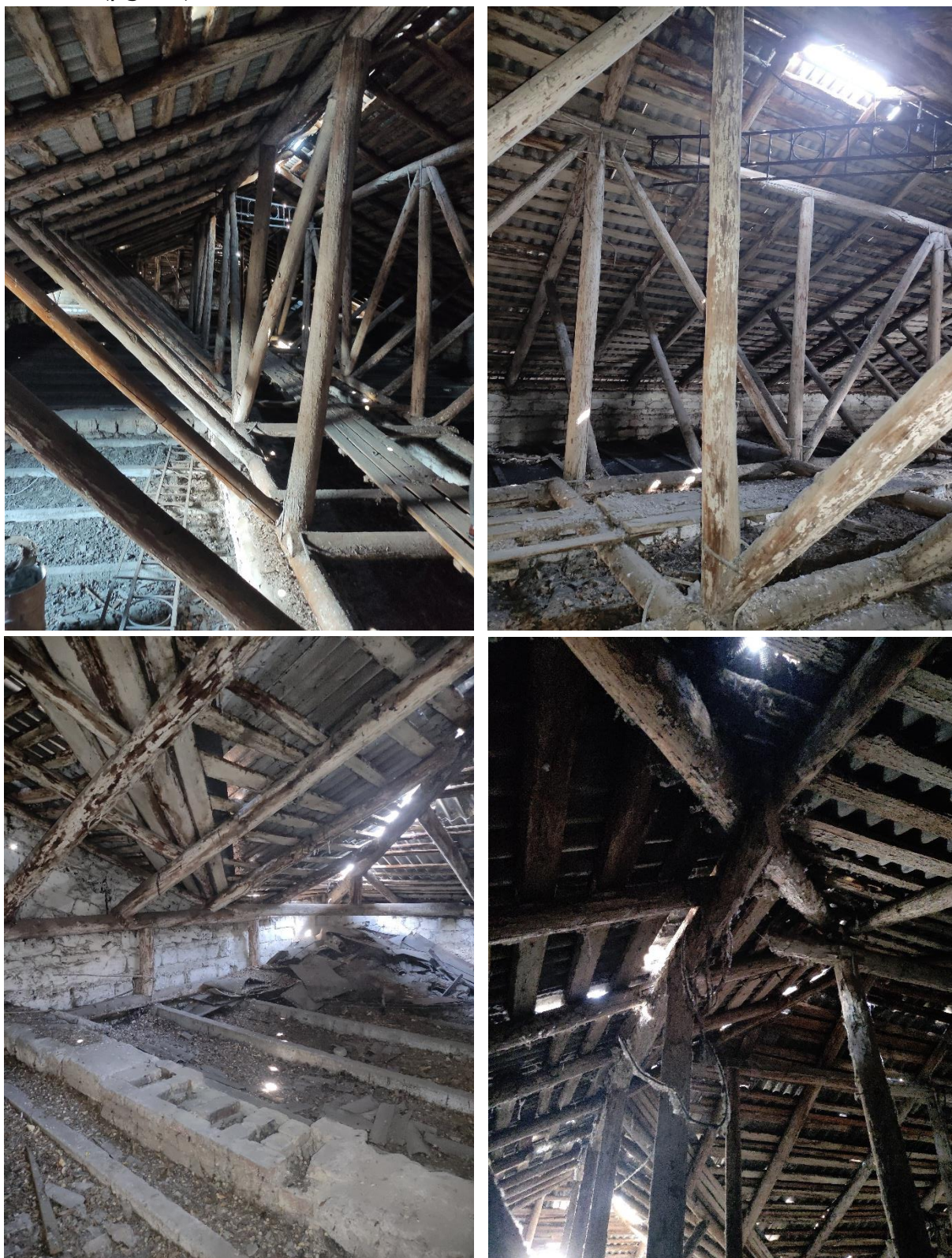
Fig. 14. Aspectul elementelor acoperișul de tip șarpantă a clădirii examinate și neconformităților depistate
