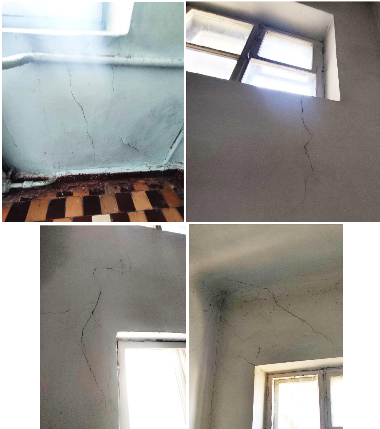
Fig. 11. Aspectul fisurilor pe suprafața peretelui exterior al casei scării neexploatate (închise) la moment
