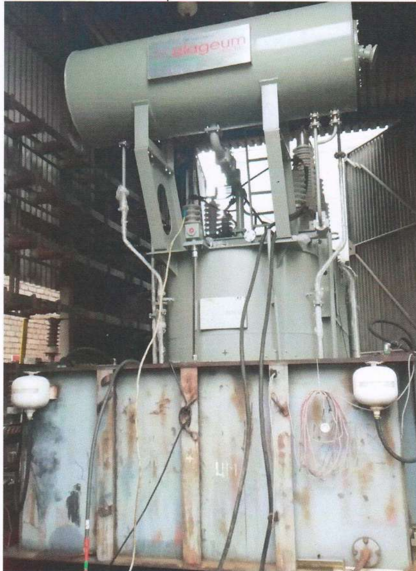
Трансформатор ТДН-16000/110 У1, зав. № 2104TDSO04 во время испытаний
