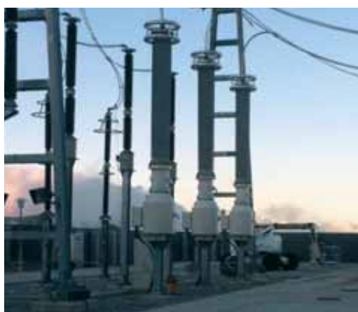
4. Индуктивные трансформаторы напряжения 420 кВ. Электрические сети Испании.
