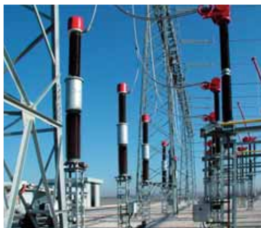
3. Индуктивные трансформаторы напряжения 420 кВ. Rede Eléctrica Nacional (Португалия).
