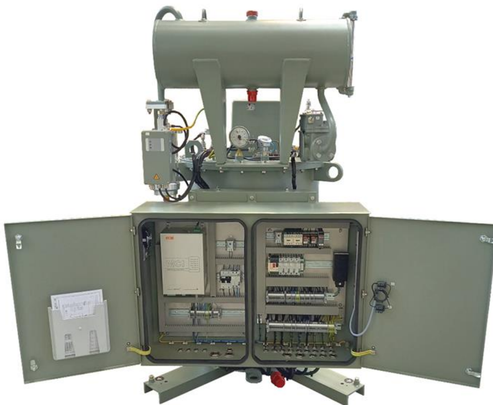
Рис. 6: Установка MCI P-01 непосредственно в шкаф управления реактора.
