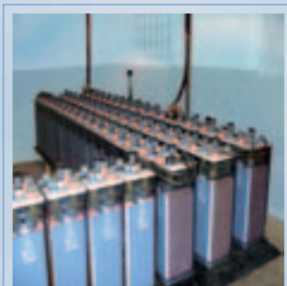
Рис.20 Смонтированная батарея Classic OPzS
