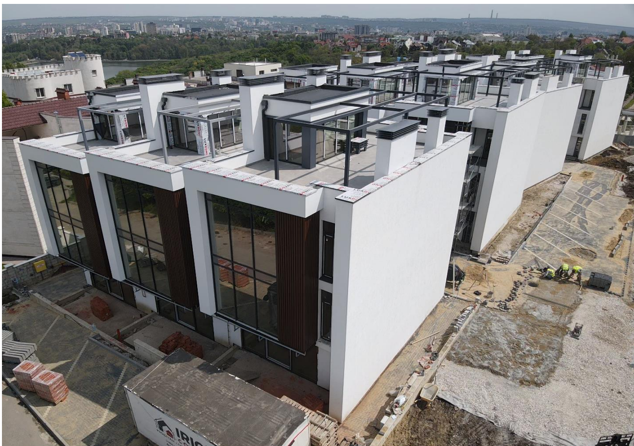
”Lucrări de termoizolare fațadă inclusiv finisarea cu ”Tink”, mun. Chișinău, sect. Centru, str. Ciocîrliei 2/10,2/11.
