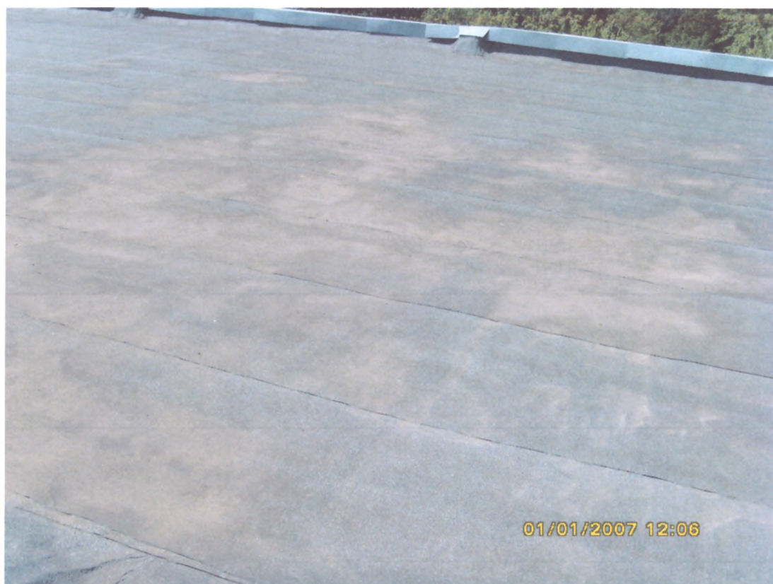
c: Anexa 6: Deformații/inconveniențe alcătuire/execuție acoperiș.
