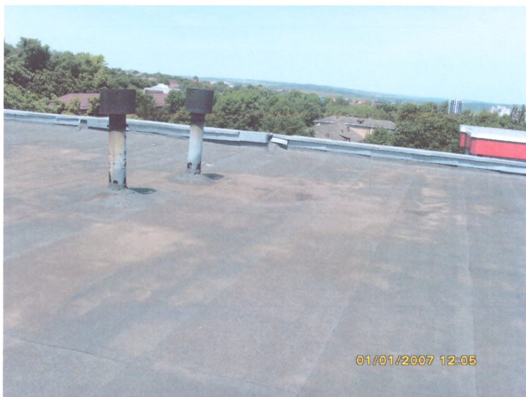
b: Anexa 6: Deformații/inconveniențe alcătuire/execuție acoperiș.
